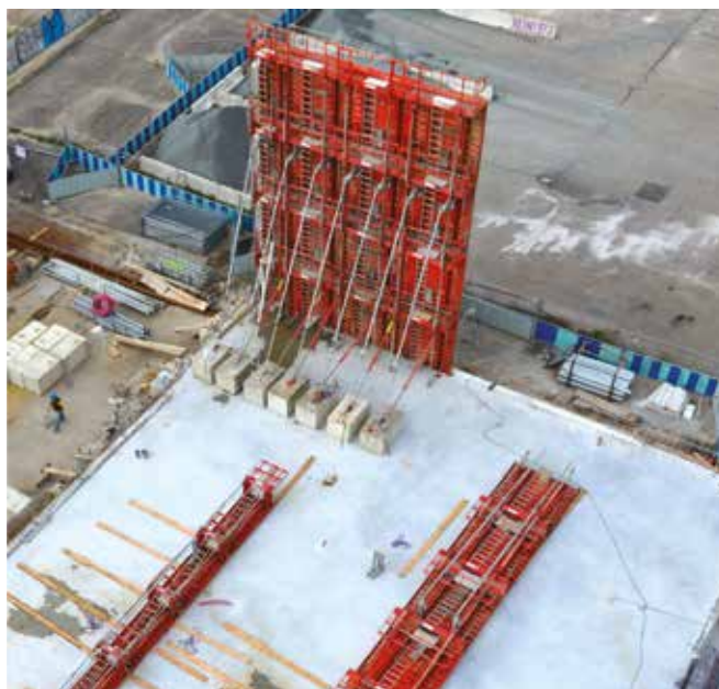
■ Voile grande hauteur chaufferie Bordeaux (33)
