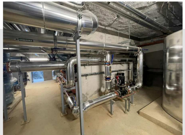
Production de chaleur de 570kW avec géothermie lycée de CREON (33)
